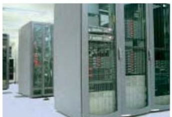
24h監視サーバールーム
