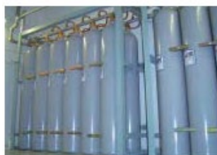
窒素ガス消火システム
